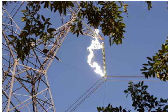
Figura 2. Arco eléctrico en cadena de aisladores
