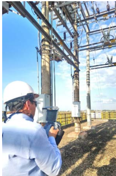
Figura 8. Detección de descargas parciales con cámaras sensibles a radiación UV
