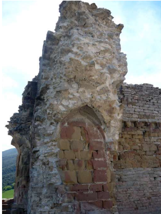
41. Restos módulo residencial 2, totalmente destruido. (Juan José Martinena)
