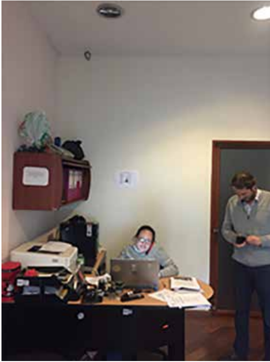
Figura 2. Estado del sistema de iluminación en el área de secretaría.
