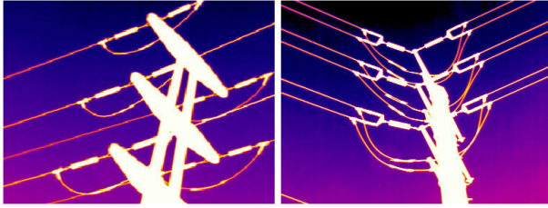
Figura 7. Imagen típica de equipos de líneas de transmisión
