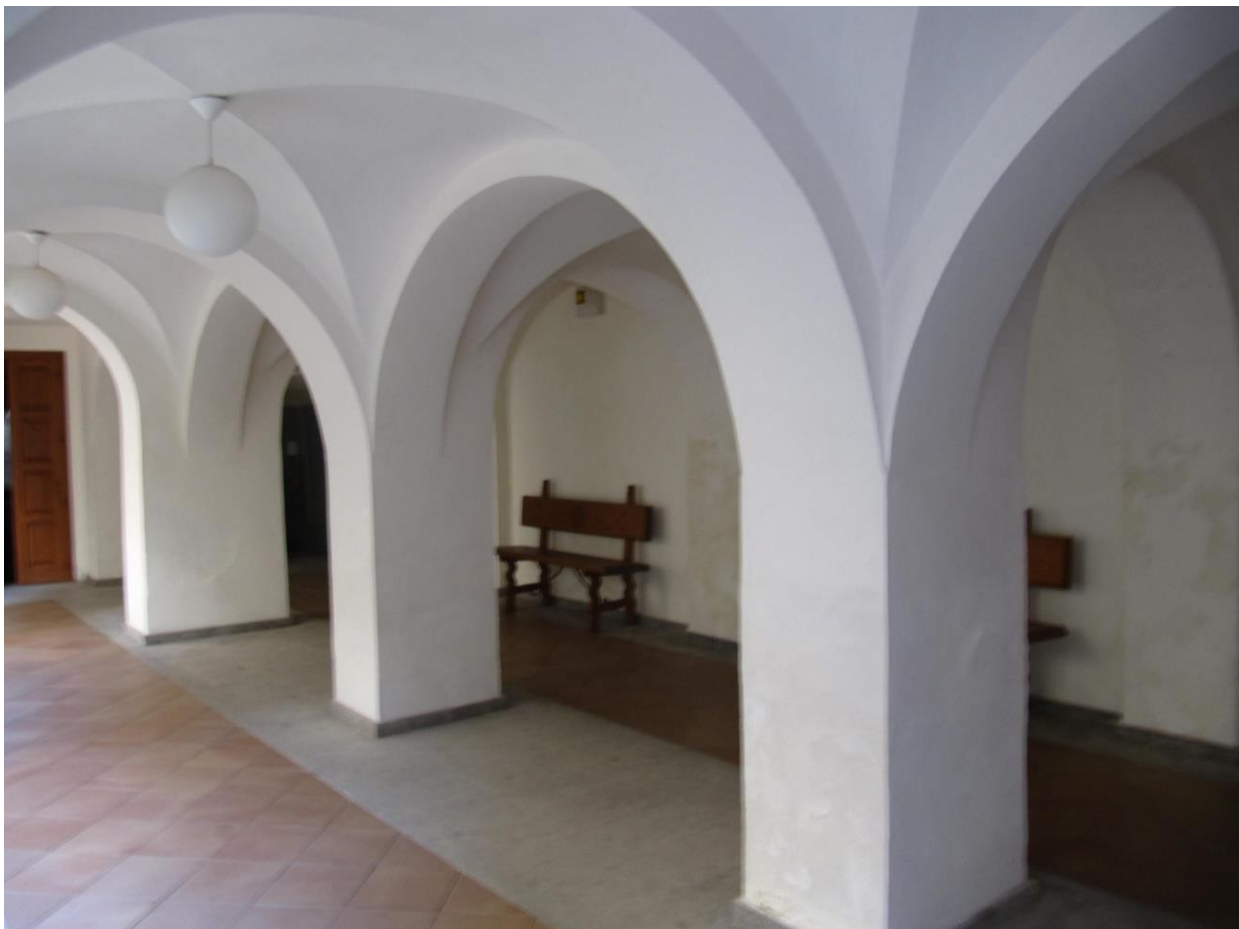
Figura 13.- Arcos de medio punto con bóvedas de arista, acceso a la capilla
