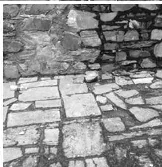
18. Corte y trayectoria, marcada en el pavimento, de la atarjea del muro de la derecha.
