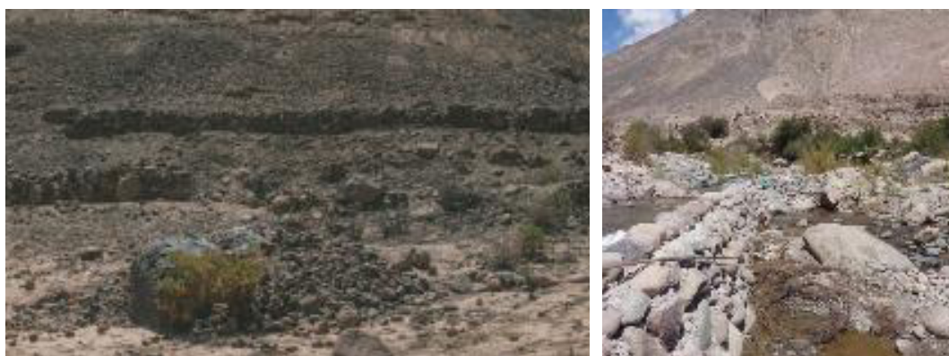
Figura N°5 Muro de defensa contra la erosión (izquierda) y desvío del río San José en Humagata (derecha)
