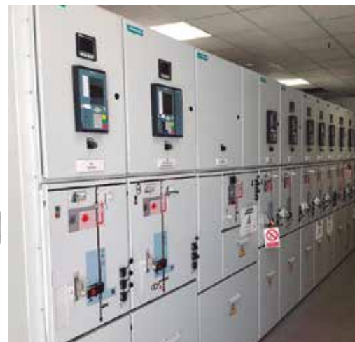
Fig. 7. Nuevas salas de operación y control.
