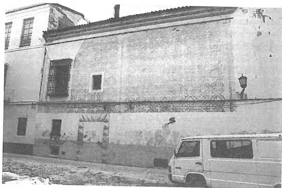
Fig. 2.— Decoración esgrafiada del muro exterior de la capilla del conjunto palaciego de los Condes de Buenavista en calle Gaona (Iglesia de San Felipe).
