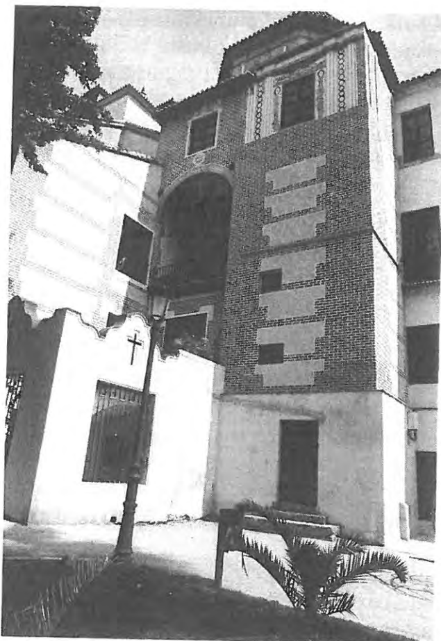
Fig. 1.— Vista exterior de la sacristía y dependencias anejas a Cripta de los Condes de Buenavista y Camarín de la Virgen del Santuario de la Victoria: decoración pintada y esgrafiada.
