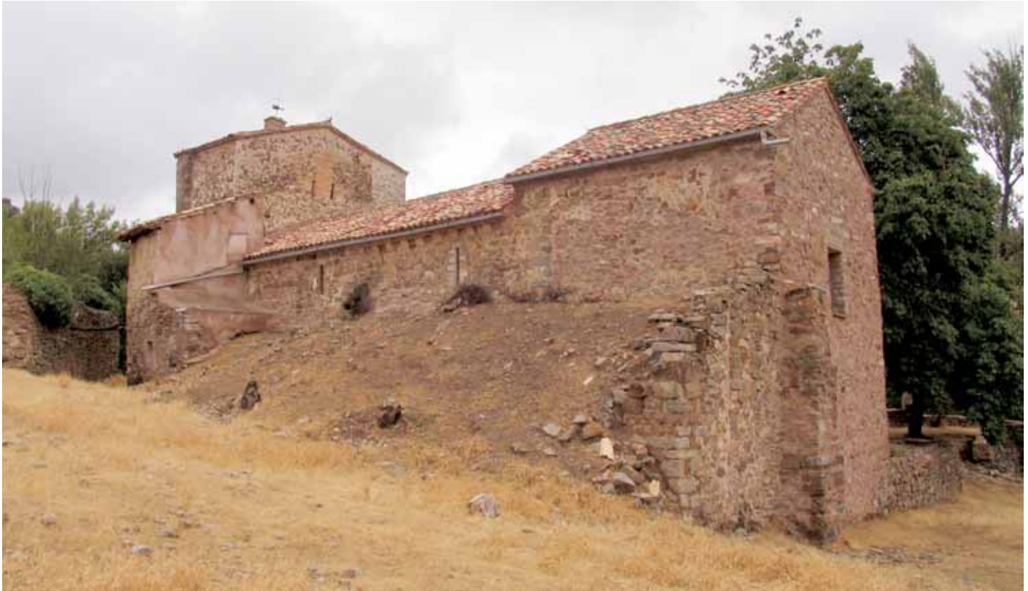
Exterior desde el Sur, parcialmente derrumbado
