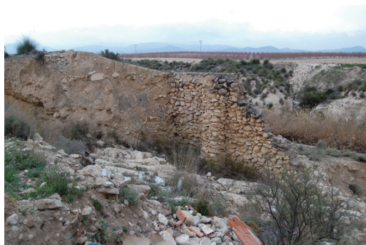
FIGURA 10 Rotura del muro delimitador entre la boquera y la rambla
