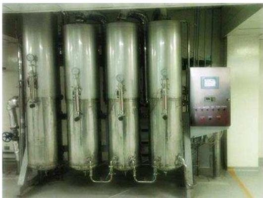
Fig. 21 Nuevo sistema de monitoreo, supervisión y control del proceso de destilación de agua
