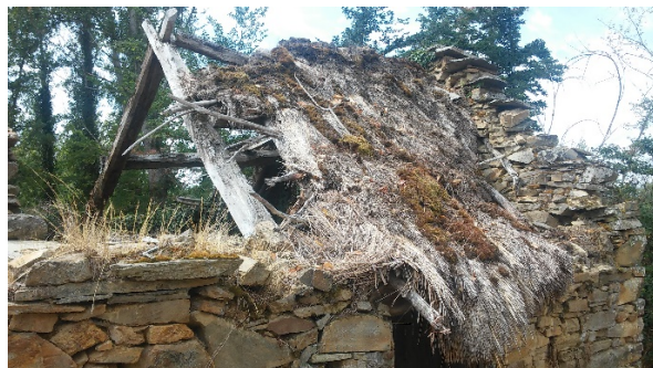
Fig. 14. Techumbres vegetales en ruinas. Lucillo.
