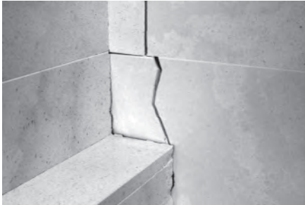
Daños por asiento de la obra producidos en la puesta en valor del horno de cal hispanorromano (Ruta de Arqueología Urbana).
