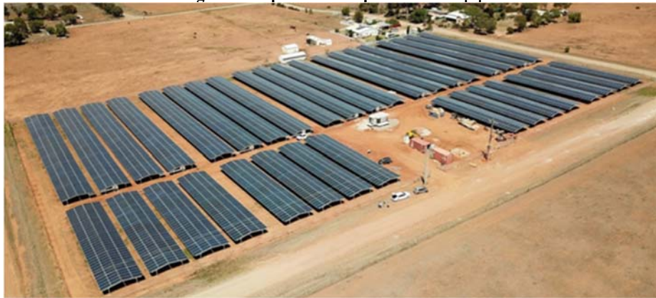
Fig. 3. Vista de la planta Yongala [10].°
