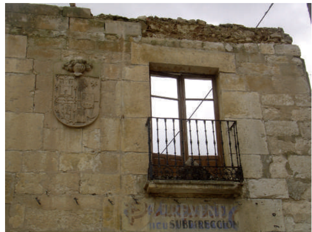
Restos de la fachada de la casa blasonada en la Plaza de Santa María de Aranda. Foto del autor, 2010.
