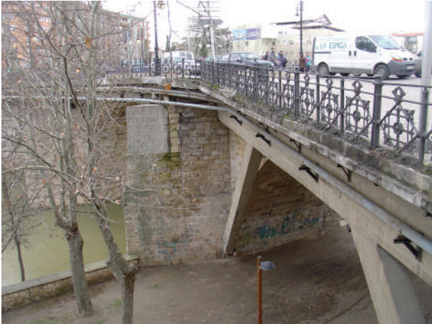
Vista inferior del puente sobre el Duero. La desafortunada ampliación de tablero, pensada desde la perspectiva del tráfico, desfigura lamentablemente el puente, que debería ser rehabilitado a su forma original. Foto del autor, 2010.
