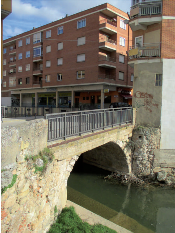
Puente de Fuenteminaya, ampliado y desfigurado por sus dos caras. El entorno carece de la capacidad evocadora de lugar histórico, al contrario que el puente. Foto del autor, 2014.
