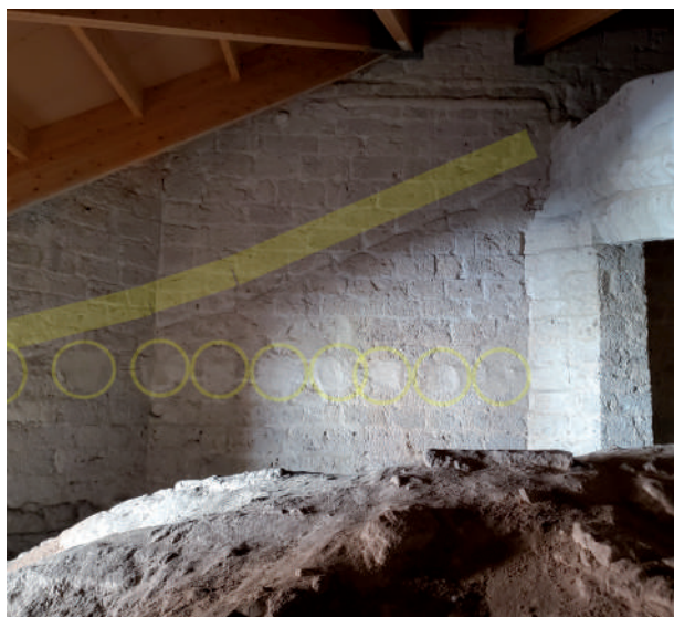
Fig. 21. Bajo cubierta de la cabecera del Evangelio. Restos de mechinales en el muro y rozas de una cubierta anterior.
