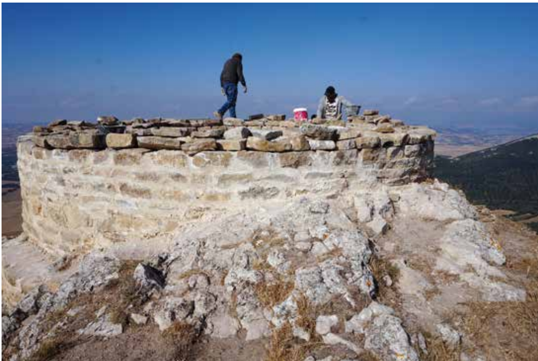
Figura 7. Finalización del refuerzo y colocación de piedras sueltas para permitir el secado del cierre del torreón.
