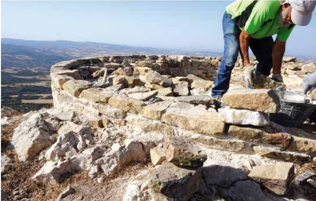
Figura 6. Otra vista del refuerzo con tres hileras para reforzar el punto más débil de la torre. Motivo de los trabajos de esta campaña.
