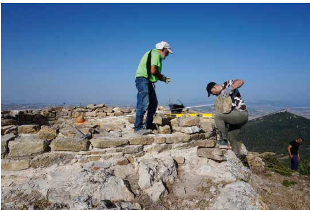
Figura 5. Refuerzo del punto problemático de la consolidación. Zona de la roca natural.
