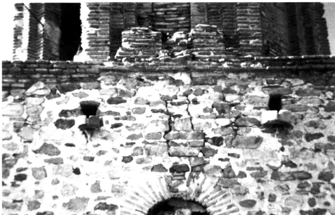
Los dos cuerpos de la torre, en el inferior dos estelas discoidales utilizadas como canaleras.
