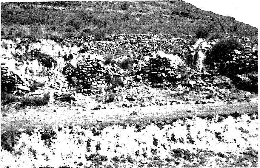
FOTO 8. Desprendimiento en bancales en Antoñanzas (La Rioja).
