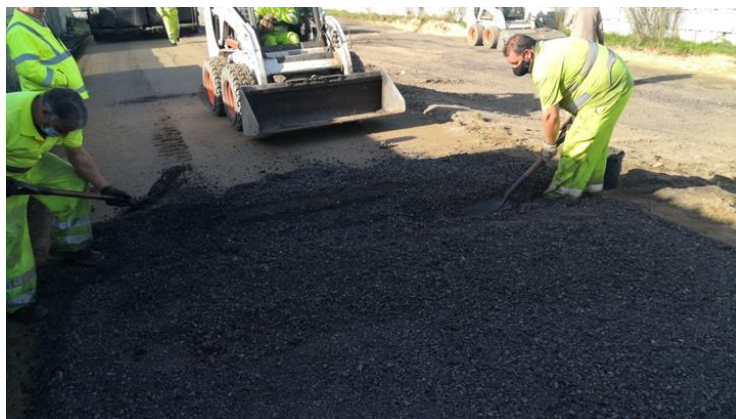
Figura 9: Trasvase de la GE desde un camión-volquete hasta la extendedora (foto superior) y proceso de puesta en obra de la capa de base 1 (foto del medio e inferior).
