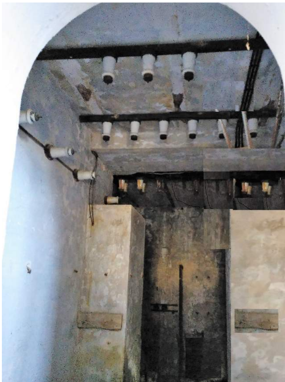
02_21_Local donde se situaban los transformadores de potencia y tensión. (En el techo se puede apreciar el aparellaje para entrada y salida de las líneas de conexión a los transformadores de potencia).
