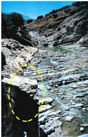
Paraje 'El Remanso'. Detalle de los daños producidos por la riada en el estribo del puente del sifón.
