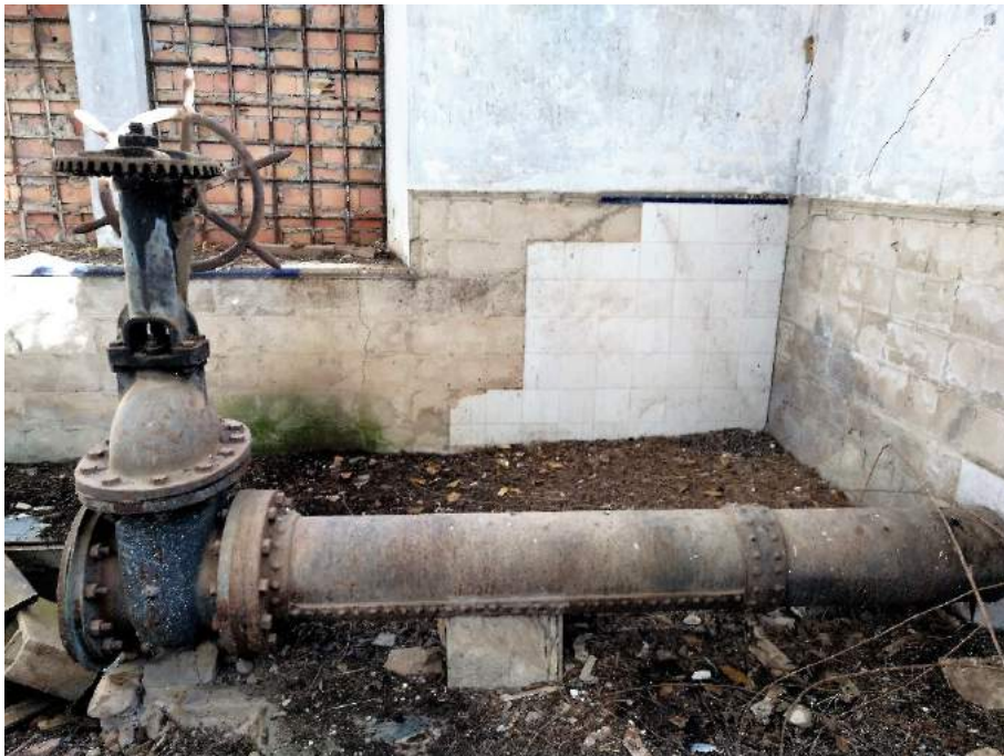
02_16_ Colector de aspiración turbina con válvula de regulación caudal.
