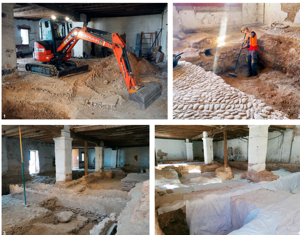
Figura 7. Vistas de los procesos de excavación mecánica (1), limpieza manual (2), documentación fotográfica (3) y cubrición del yacimiento (4).
