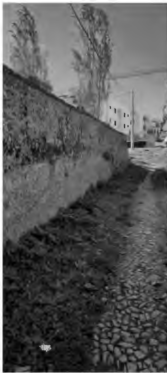
Figura 11: Paredes abandonadas con oquedades en área ajardinada y cercana a zona residencial. Cáceres.
