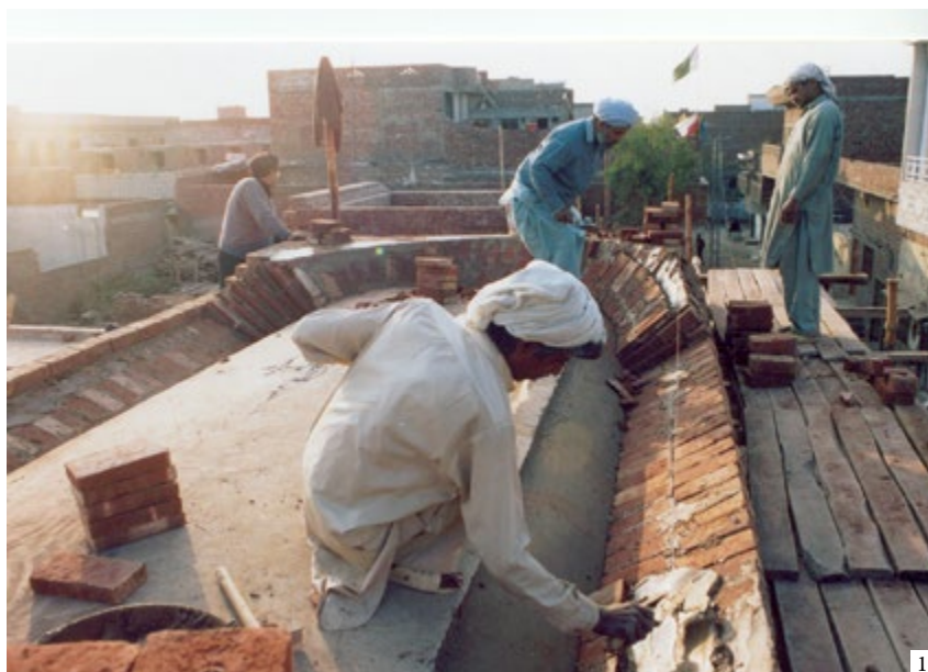
1: Building a flat dome with falsework. 2: Detail of brickwork | 1: Construcción de una bóveda plana con cimbra 2: Detalle de la fábrica de ladrillo | 1: Construção de uma cúpula plana com cimbres 2: Detalhe da alvenaria
