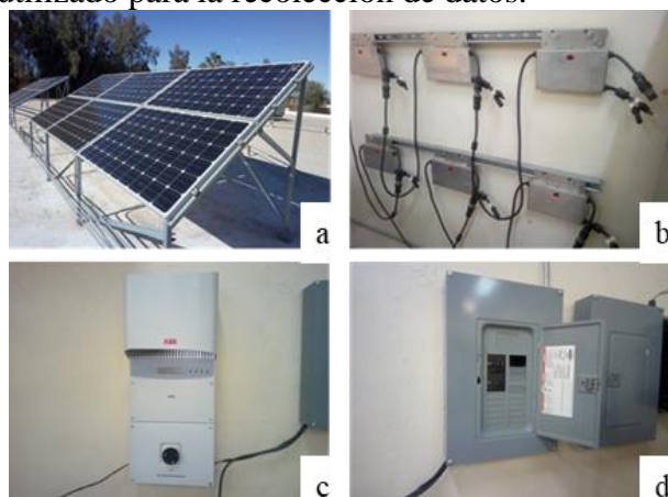
Figura 2. Elementos del banco de pruebas: a) Módulos fotovoltaicos, b) Microinversores, c) Inversor central, d) Tablero de distribución.
