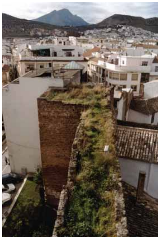
Torre 1 (siglo XV) y Lienzo 1 (siglo XV). Estado antes de la intervención.
