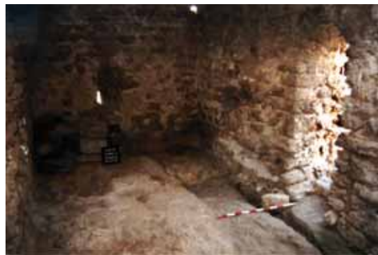
Torre 6. Cámara de habitación. Vista del interior, finalizados los trabajos, con la puerta de acceso.
