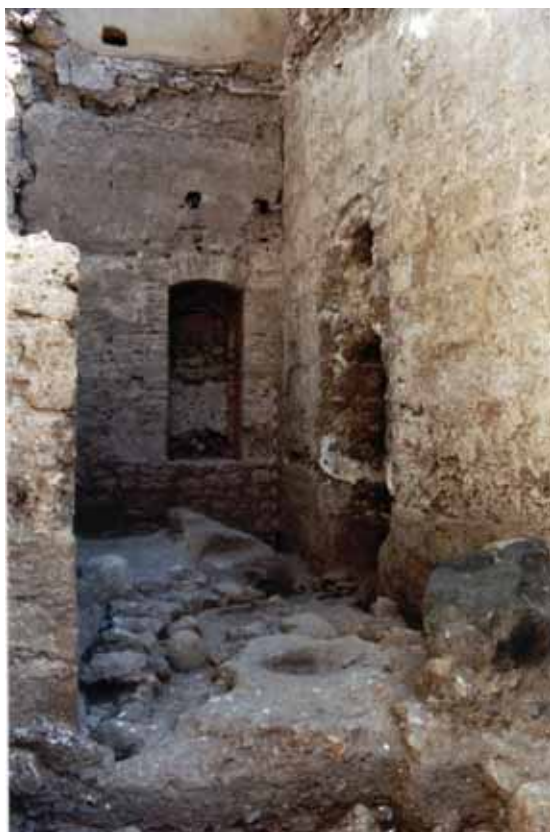
Zona 1. Sector entre la poterna medieval (derecha) y el edificio adosado a los lienzos L7 y L8 (c. siglo XVII), una vez desmanteladas las estructuras postmedievales parasitarias.
