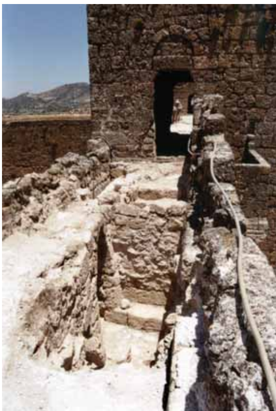
Lienzo 1. Panorámica del paso escalonado directo al adarve del lienzo, desde el interior del castillo. Al fondo, la entrada a la Torre 2. El tramo de escalera mejor conservado se encuentra condenado por un muro de mampostería no retirado durante la intervención.
