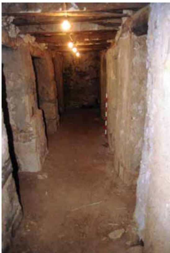
Torre del homenaje. Planta Primera Inferior. Sótano o bodega postmedieval, tras la limpieza realizada.
