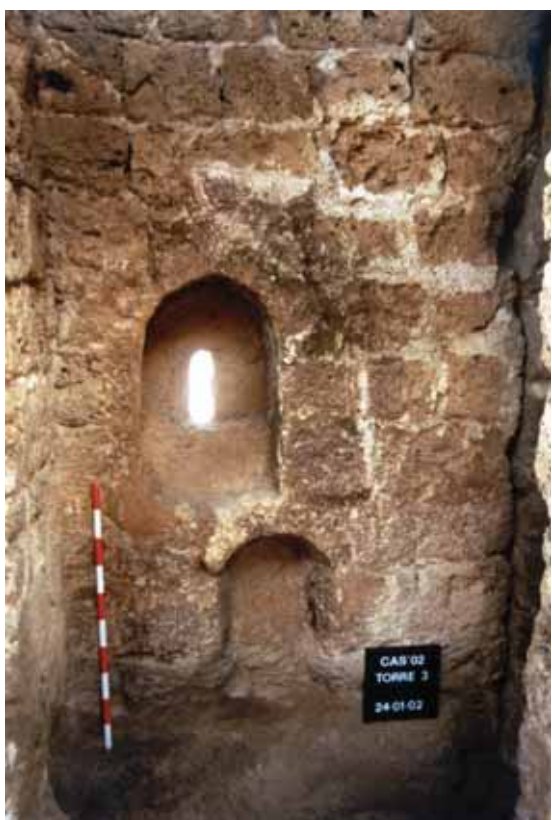
Torre 3. Adarve cubierto. Ventana y aspillera medievales (siglo XV) condenadas por obra postmedieval.
