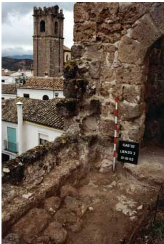
Lienzo 3. Detalle de la unión entre el lienzo y la Torre 3 al término de la intervención, que aporta datos de enorme interés, al ser el único testimonio arquitectónico (para el siglo XV) que pone en relación el pavimento original del adarve (mortero de cal), el parapeto aspillero hasta su cota máxima, también original, y la altura total de la merlatura.
