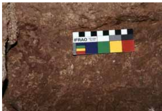
Torre del homenaje. Planta Primera Inferior. Detalle del mortero hidráulico de cal, repasado a la almagra, que confirma el uso original de la planta Primera de esta torre como aljibe.
