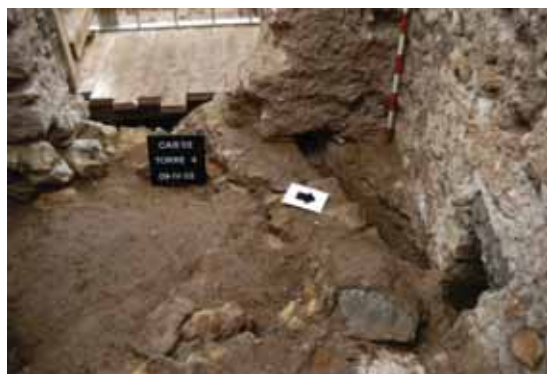
Torre 4. Cámara de habitación. Detalle de la esquina del lado de la puerta de acceso, donde se conserva el canalillo de evacuación de aguas pluviales procedentes del Lienzo 10, a través de la salida correspondiente conservada en la torre.
