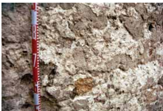
Torre 4. Cámara de habitación. Detalle del enjalbiego medieval de las paredes, con lechada de cal aplicada con brocha.
