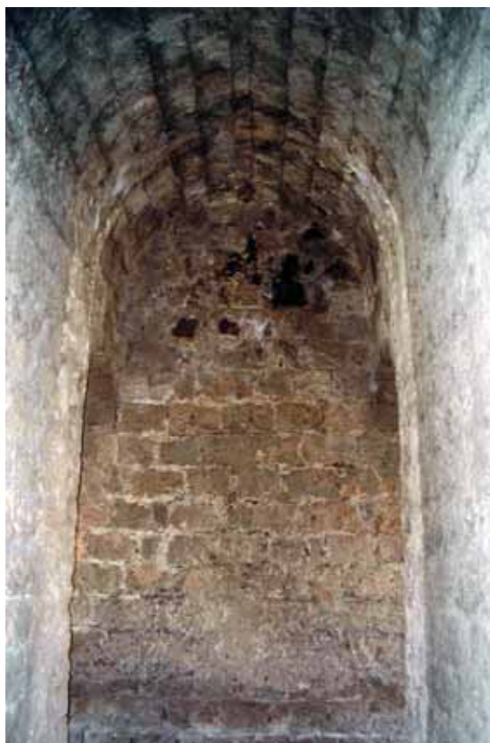
Torre 2. Interior al término de los trabajos, con la recuperación de la cantería y espacio medievales originales.
