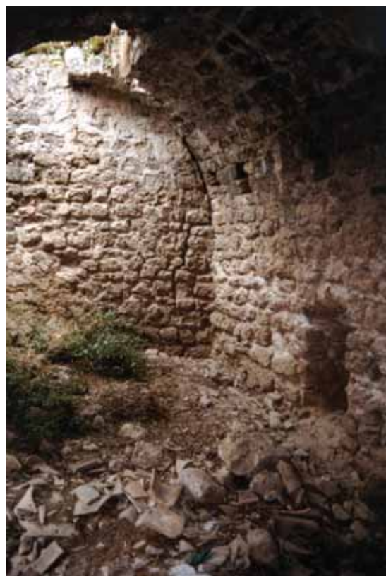
Torre 6. Cámara de habitación. Detalle antes de comenzar la intervención, con abundante escombros y desechos en su interior.
