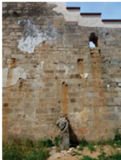
50.- Detalle de un tramo de la pared de la nave del evangelio de la iglesia.
