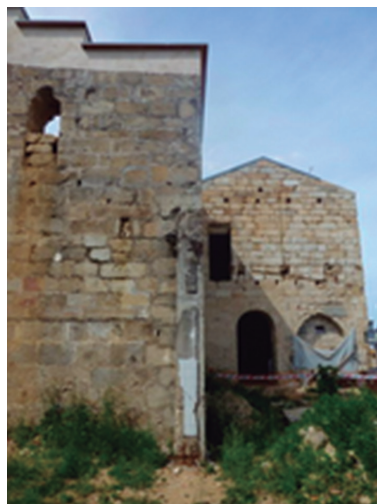
49.- Vista del estado actual de la esquina de la nave principal de la iglesia y la pared norte del crucero del lado del evangelio.
