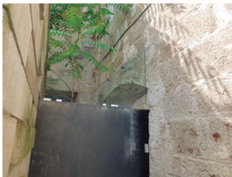
59.- Puerta de comunicación de la nave principal de la iglesia con el claustro (Nº 29), situada en la esquina noroeste de la pared del evangelio, junto a la entrada principal.
