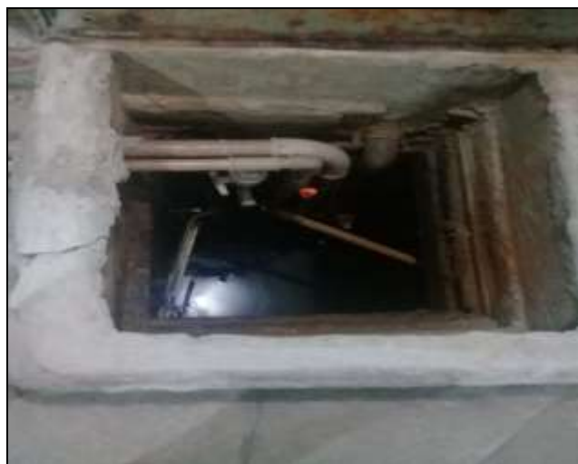
Figura 4: Poço tubular construído, dentro dos padrões exigidos.
