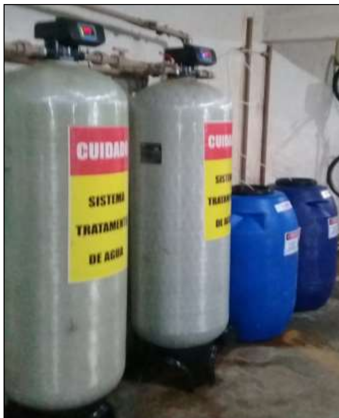
Figura 5: Sistema de tratamento de água implantado.
