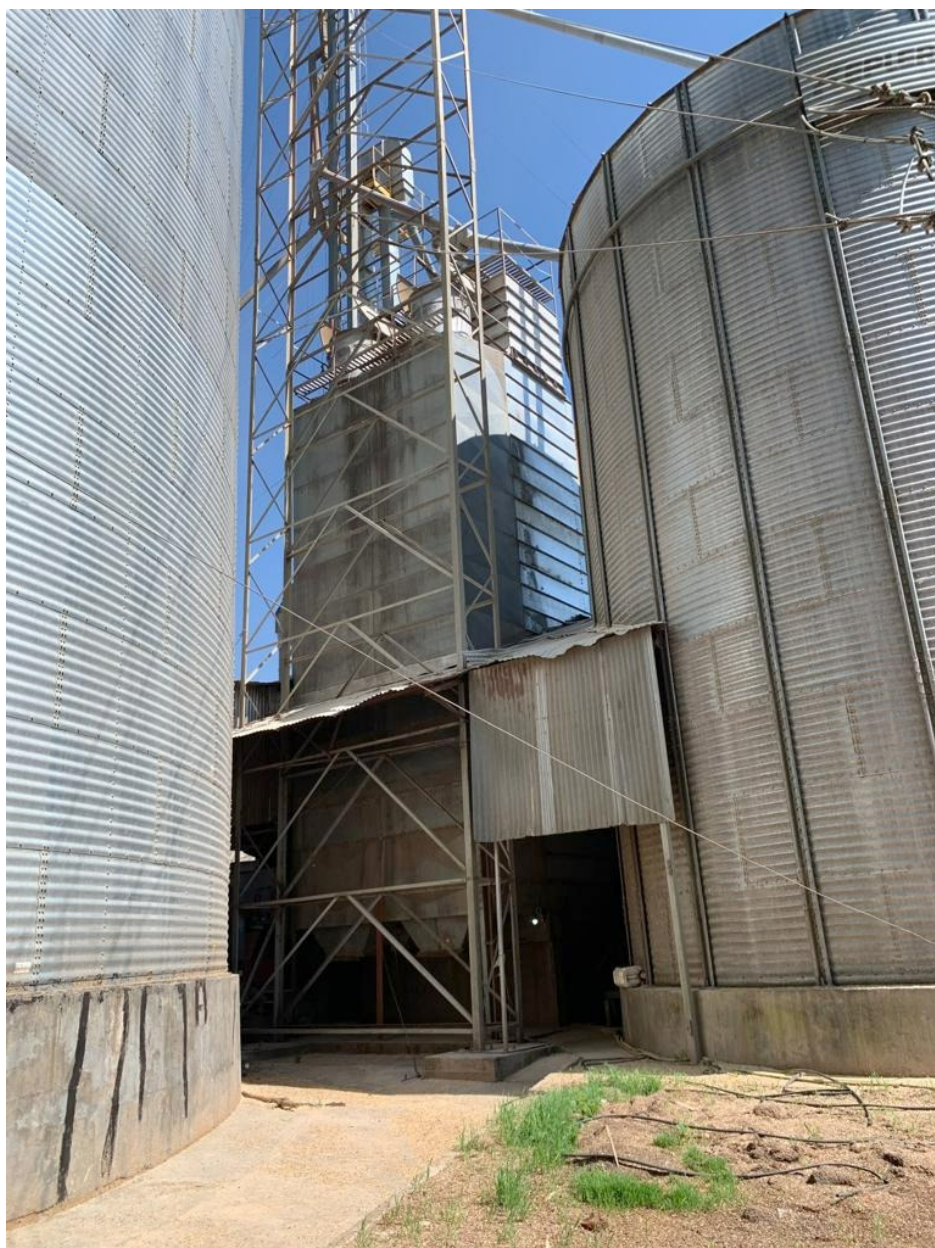
Figura 3 – Secador de grãos da unidade armazenadora da Fazenda Cachoeira, município de Ivaí, estado do Paraná (Brasil).
