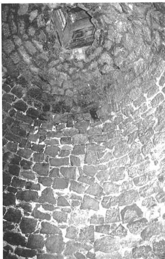
Zona superior de las paredes del pozo, bóveda de aproximación de hiladas de piedra y abertura superior cenital de la nevera urbana de Calanda (07/11/98).
