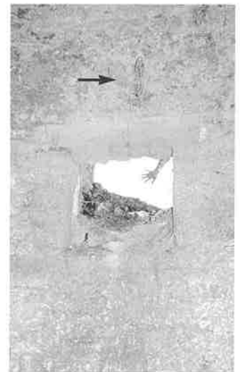
Aspecto interno de la abertura lateral de la nevera de Valdealgofra, apreciándose la vigueta de madera para colocar la polea, situada en su zona superior
