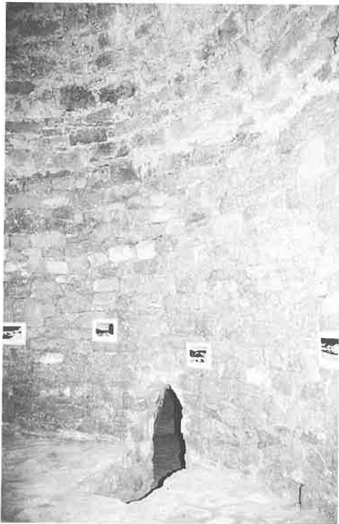
Vista interior de los muros de la nevera urbana de La Cañada de Verich y entrada actual artificial (06/06/98).
