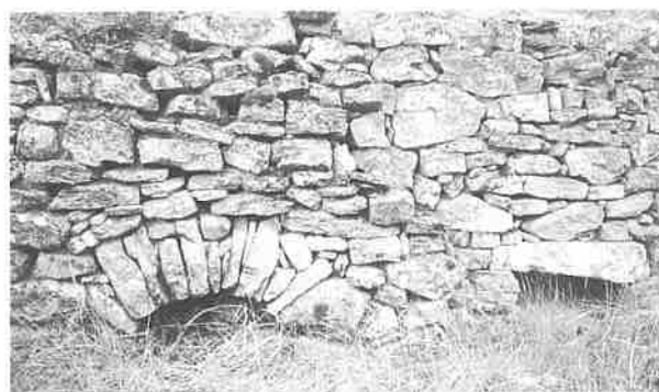
Posible arbellón exterior del sistema de desagüe del depósito de nieve urbano de Fórnoles (11-12/09/98).
