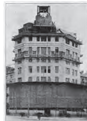
EDIFICIO DE LA COMPAÑÍA TELEFÓNICA NACIONAL DE ESPAÑA EN BARCELONA MANUEL BADUELL - BARCELONA CONTRATISTA DE LA FACIADA EN ESTE EDIFICIO SE HAN UTILIZADO LOS ANDAMIOS PATENTADOS DE SEGURIDAD DE LA UNIVERSAL PATENT SCAFFOLDING CO. SIN HABER OCURRIDO ACCIDENTE ALGUNO. ALQUILADOS (NO VENDIDOS) POR Allied Machinery Company, S. A. E. MAGINARIA MODERNA PARA CONTRATISTAS Consejo de Ciento, 318 BARCELONA
