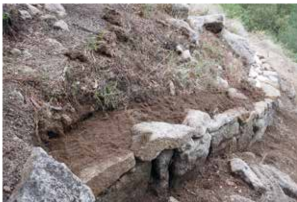
FIG. 10 Proceso de tapado con tierra del propio yacimiento encima del drenaje y el geotextil de poliéster.
