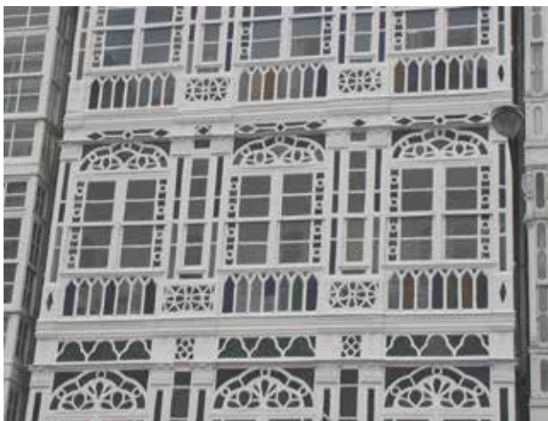
Fig. 10. Detalle de las galerías del número 25-27 de Rego da Auga antes de la restauración en 2005 (Foto: autor)
