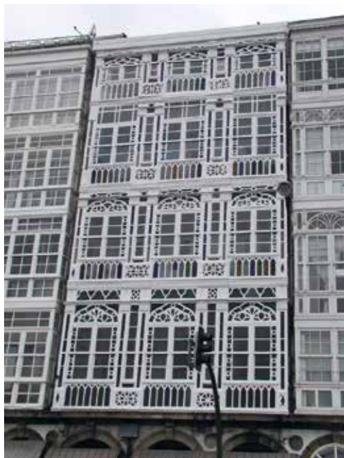
Fig. 17. Estado de las galerías en 2003 (Foto: autor)
