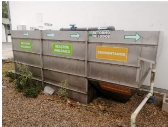
FIGURA 5. Fotografía de la planta instalada.
