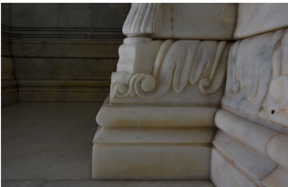
Detail of a column base | Detalle de la basa de una columna | Pormenor da base de uma coluna (Raza Kazim)
