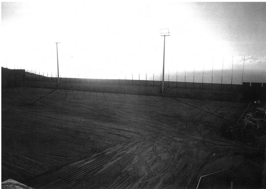
Fase final de la construcción del Estadio Virgen de las Nieves, temporada 1997-1998 [MSB]
