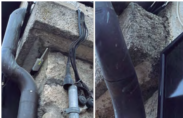
Fig. 5. Detalles de la cornisa de La Posada en la parte de la calle Real. Por el lado izquierdo continúa, mientras que por el derecho está rematada (fotografías del autor).
