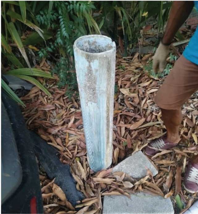
Figura 2. Poço tubular inativo no bairro Ilha de Santa Luzia
