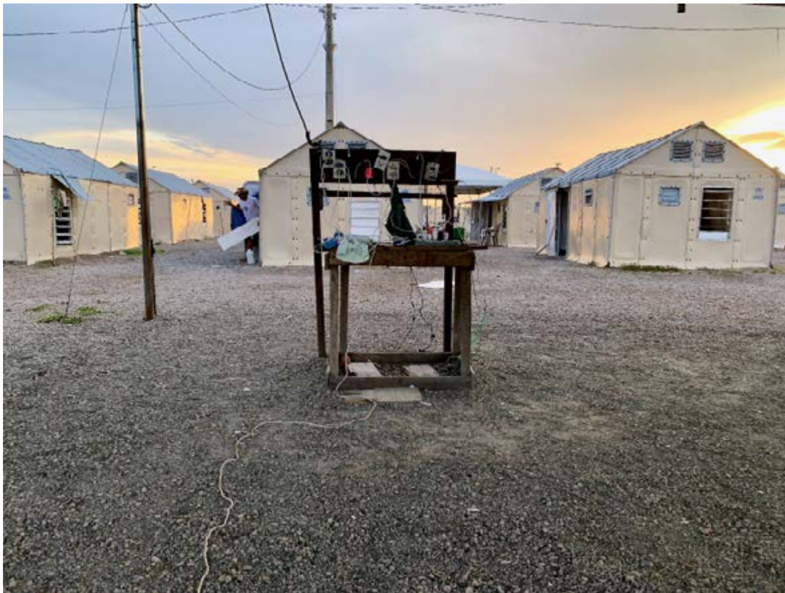
Ponto de energia coletivo no abrigo para refugiados venezuelanos Rondon 1. As barracas não têm acesso à energia elétrica.
