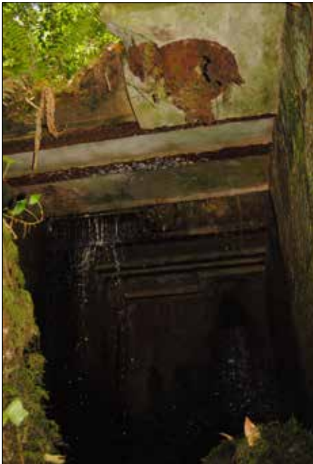
Interior da canle de descarga. En 1º termo a tubaxe metálica de descarga dunha das turbinas.
