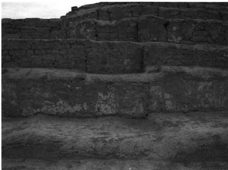
FIGURA 4: ESTADO ACTUAL DE LOS MURALES
