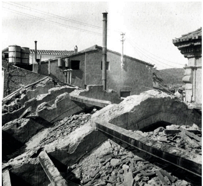
Il·lustració 3. Enderroc de l'església de la Sang. Arcs de rajola amb la lluada pintada simulant dovelles que suporten els cabirons de l'enteixinat de l'església gòtica.
