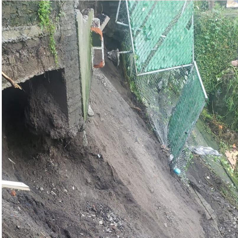
Figura 5. Afectaciones en la vivienda analizada
