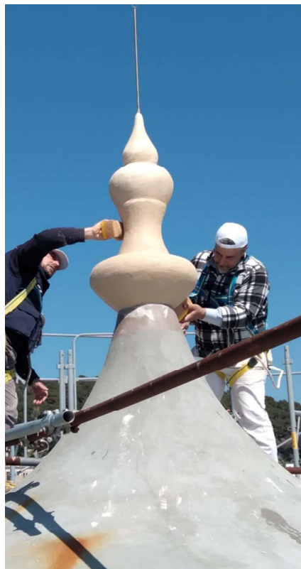
Figura 4. Procesos del 2023. Fase de trabajo de restauración de la cúpula: aplicación de la capa de estuco. Imagen de los autores.
