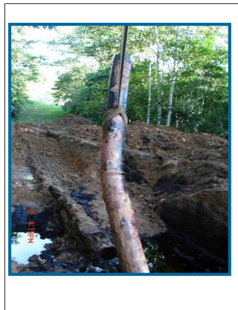
Figura N° 1.- Arruga en tubería en evento de 2006 [11].
