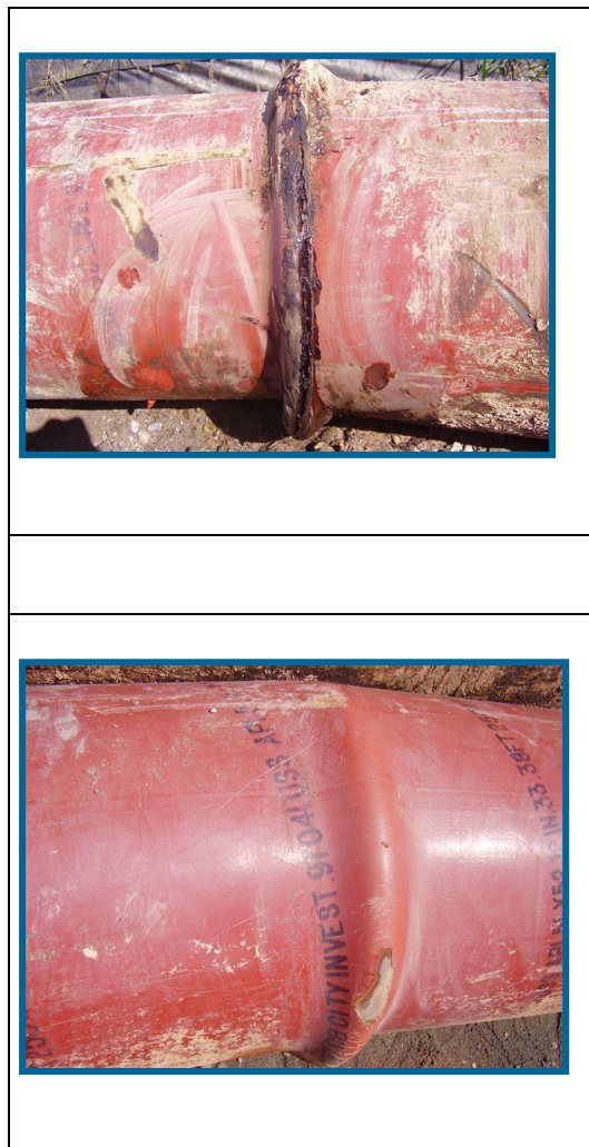
Figura N° 2.- Arrugas en tuberías en evento de 2007 [11].
