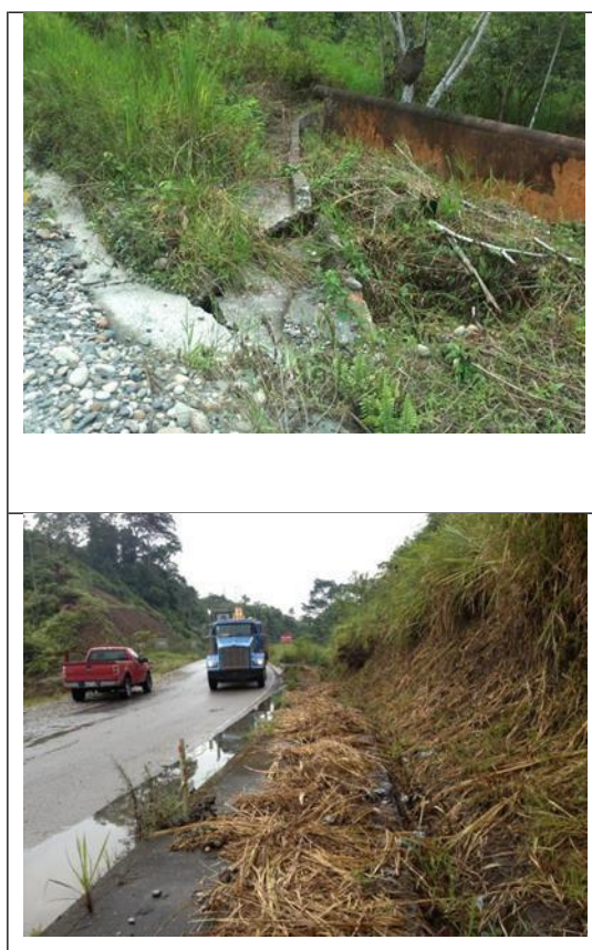
Figura N° 13.- Cunetas rotas y que no funcionan. Fotos tomadas en vía ubicada junto al derecho de vía en estudio.
