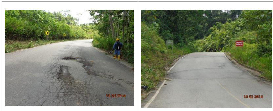
Figura N° 14.- Evidencias de hundimientos y desplazamientos del suelo [2].
