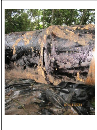
Figura N° 3.- Arruga en tubería en evento de 2014 [12].
