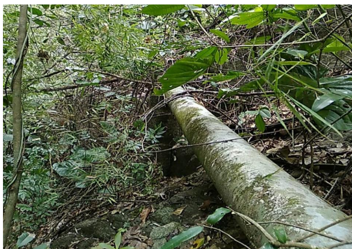
Figura 1. Tubería en PVC RD-18
