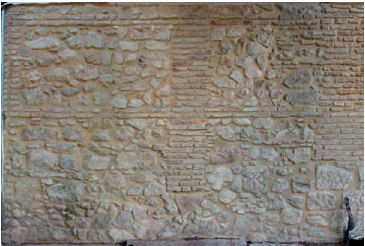
Lám. 12. Paramento inmediato a la puerta del Castillo de los Condes de Cabra.
