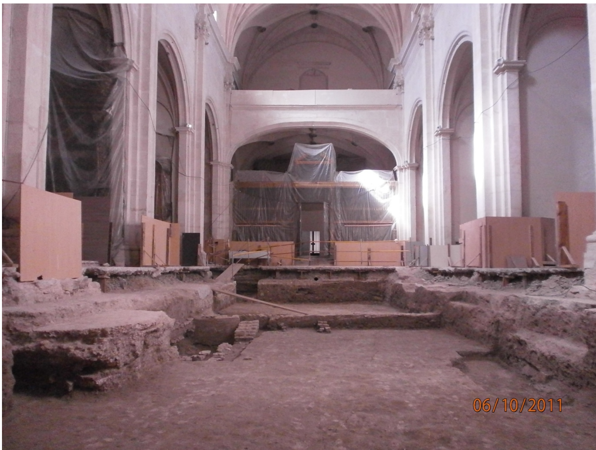
Foto 10 Excavación abierta y paralización de la obra por falta de presupuesto en 2011.
