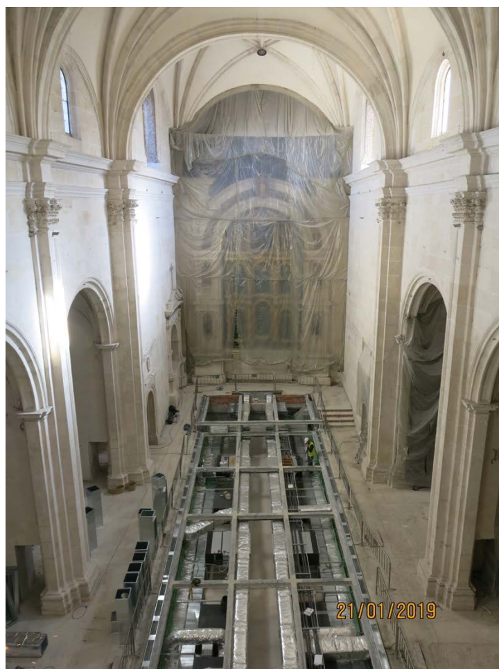
Foto 15. Integración de las instalaciones en la cámara
