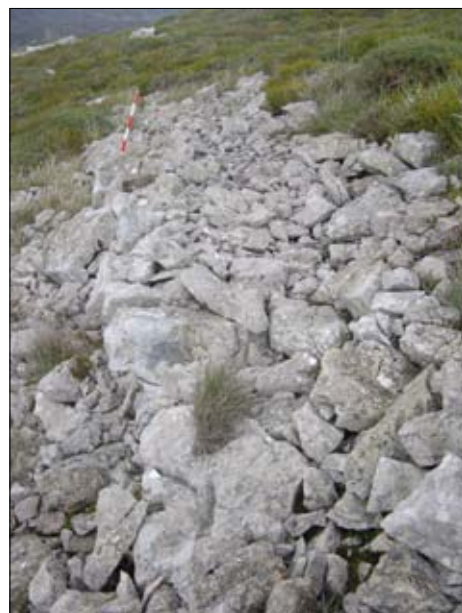
Imagen 1. Derrumbe y base de muralla junto a acceso norte.
