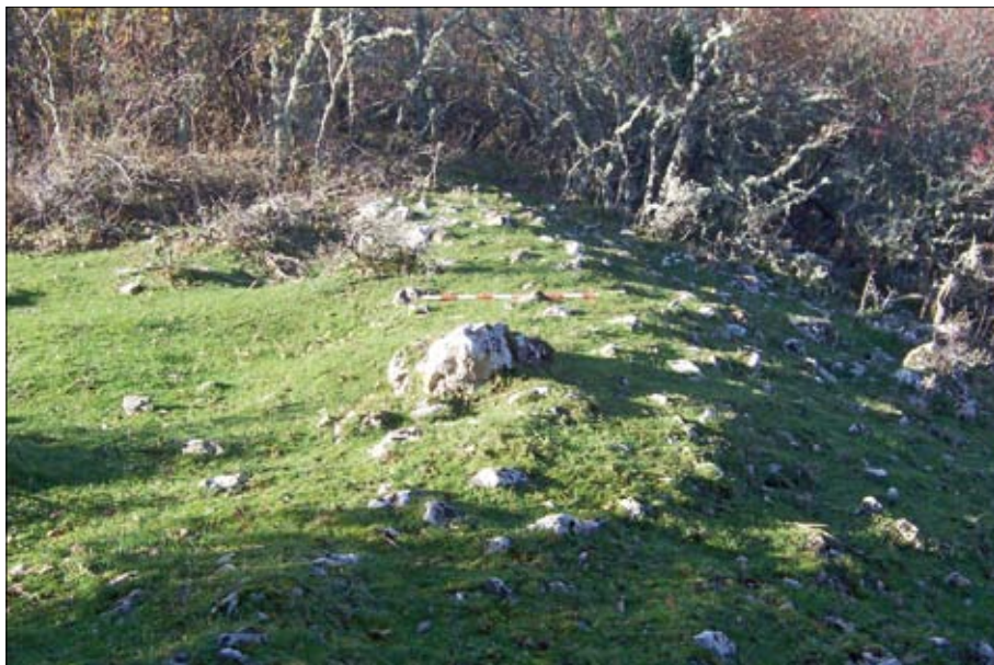
Imagen 2. Detalle de la estructura y derrumbe de la muralla.
